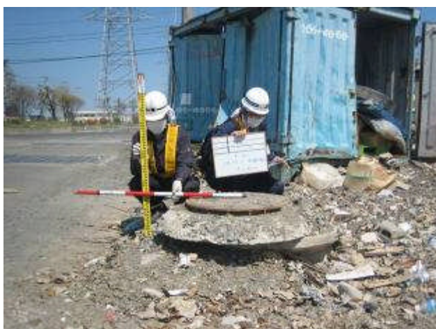
【マンホール浮上、ずれ】
