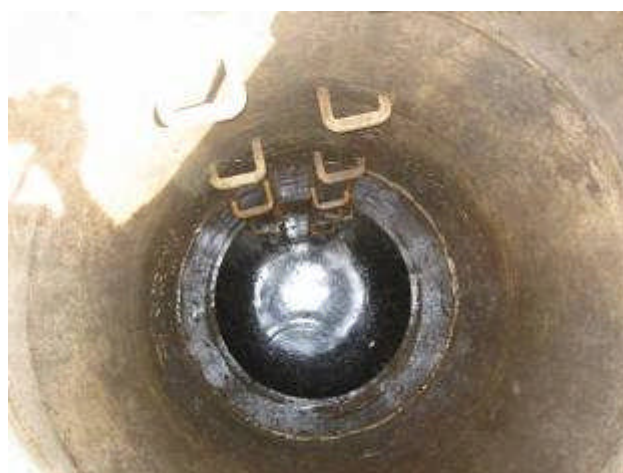
【マンホール内滞水】
