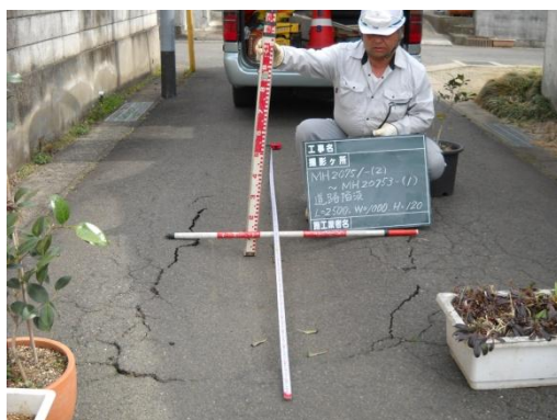
管路上部の路面陥没
