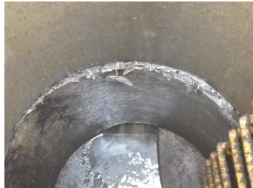
躯体ブロック上縁部の破損
