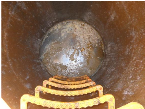
マンホール内滞水
