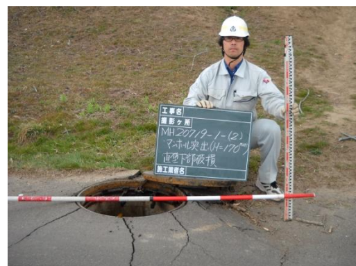
マンホールの突出
